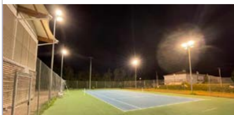
Éclairages du terrain de tennis
